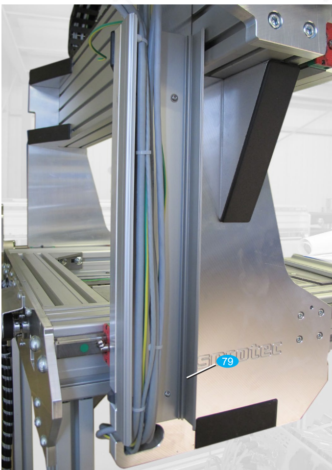
Bild 3: Kabelführung durch Kabelkanal. Zur besseren Übersicht fehlt die Abdeckung.
