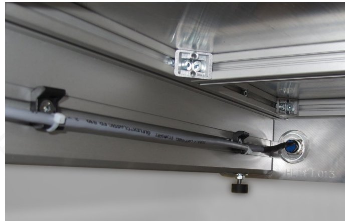
Bild 8: Steuerleitung zum Not-Aus-Schalter
