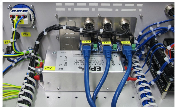
Bild 2: Netzfilter vor Ausgangsblende
