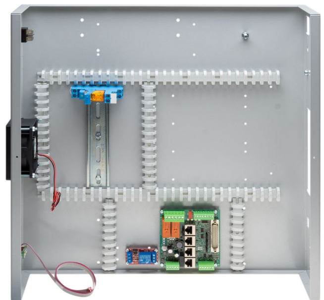
Fig. 12: Gehäuse mit Einbauten vor Beginn der Verkabelung
